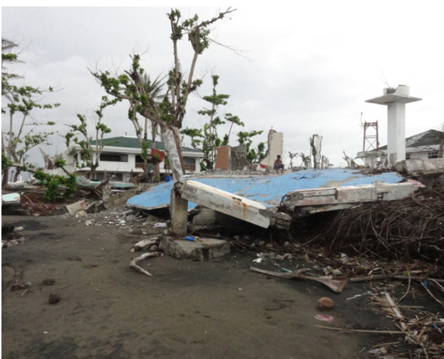
図 4. 沿岸部で被災した鉄筋コンクリートの家屋と基礎の洗掘の状況 (バラングイ 87)
